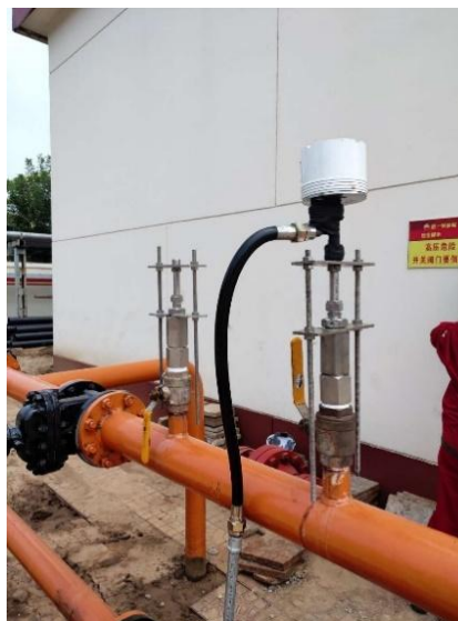
图 2. CST400C 电阻腐蚀监测仪安装现场
